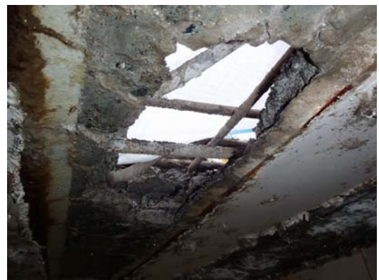
写真-3 コンクリート抜け落ち
