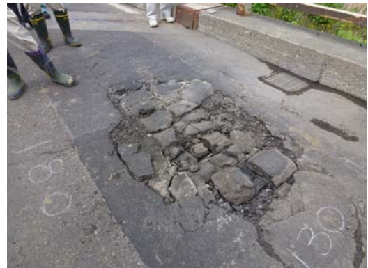
写真-2 舗装ひび割れ
