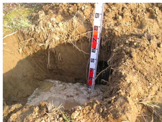
写真-5 滞水箇所の状況 (A防雪林)
