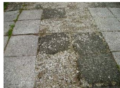
写真-2 劣化したブロック舗装 (北海道)
