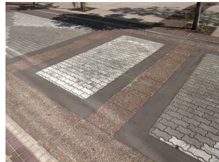
写真-10 色の褪せてしまった インターロッキングブロック舗装(北海道)
