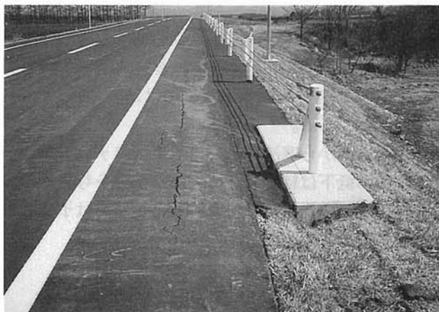
写真-2 縦方向ひびわれ
