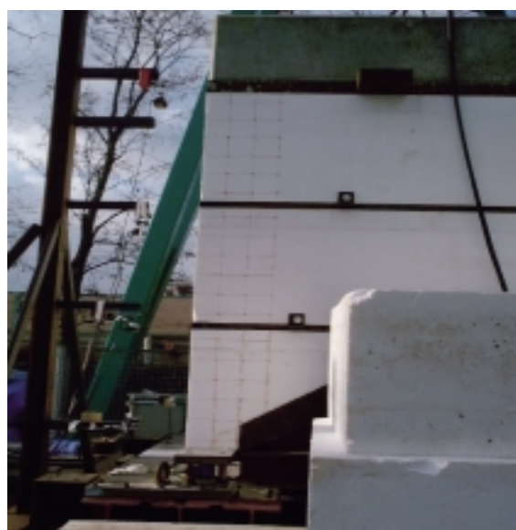
写真 - 2 レベル2加振後の状態 (ケース2: 上部アンカーのみ)
