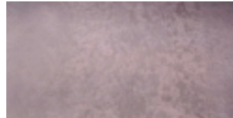
図 - 12 100台走行後の路面状態 (普通乗用車スパイク)
