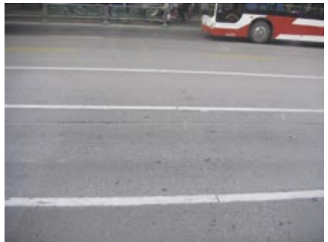
写真-11 市内の舗装路面状況
