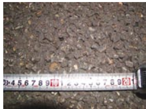
写真－1 中温化工区の路面の状態
