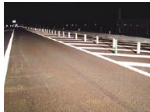
写真－2 中温化工区の路面の状態（遠景）
