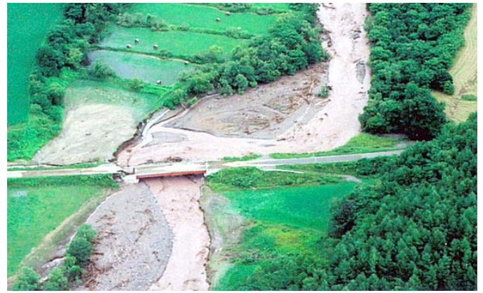
写真-5 栄進橋の被災状況 (シン技術コンサル提供)
