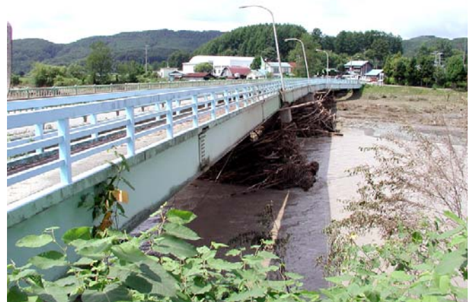
写真-2 貫気別橋(人道橋)の被災状況
