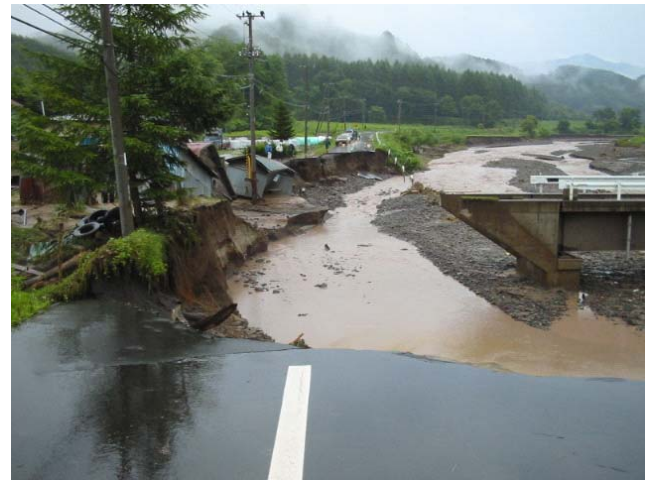
写真-6 貫気別川河岸の浸食による主要道道平取静内線の被災 (北海道提供)
