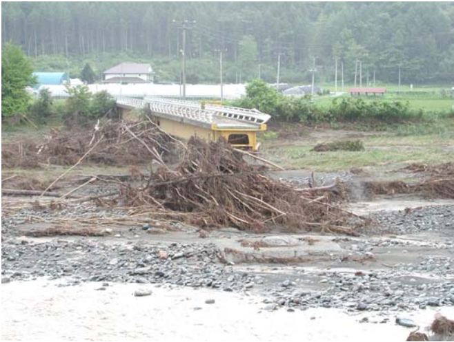
写真-3 アブシトエナイ橋の被災状況
