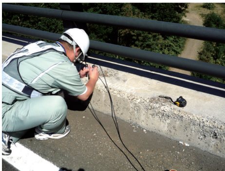
超音波(表面走査法)による劣化度評価
