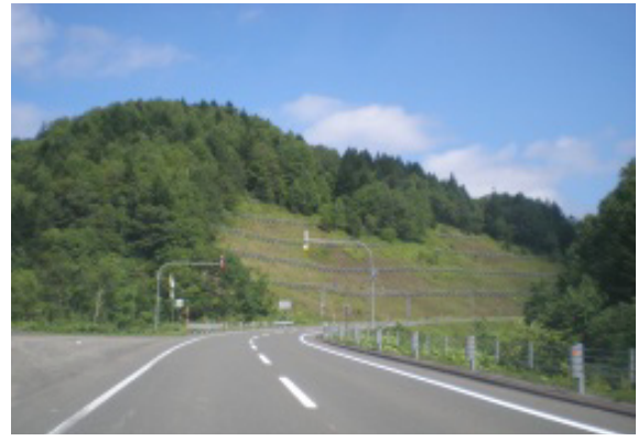
写真-2 植生回復がなかなか進まない積雪寒冷地の切土のり面
