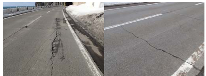
写真-1 縦断ひび割れ 写真-2 横断ひび割れ
