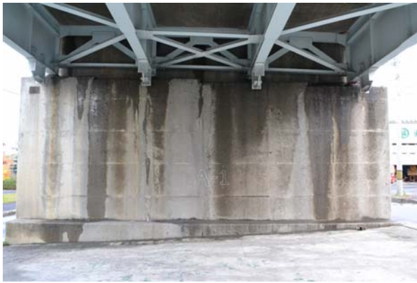
写真-1 橋台正面部劣化箇所例
