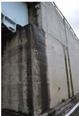
写真-2 橋台側面部劣化箇所例
