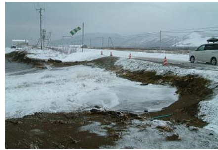
(a) 被災事例1 (A地区)
