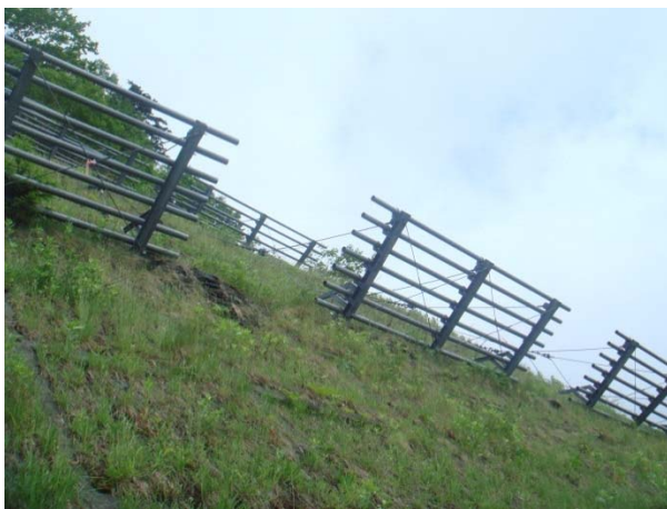
図3 道路沿い斜面に設置されている吊柵 (札幌市中山峠)
