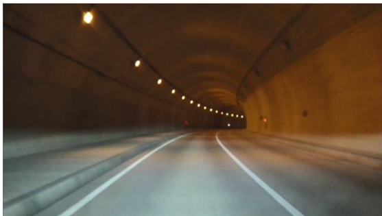
写真-2 神岬トンネル基本照明点灯状況(夜)
