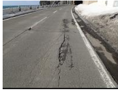
写真-3 クラック (縦断方向)
