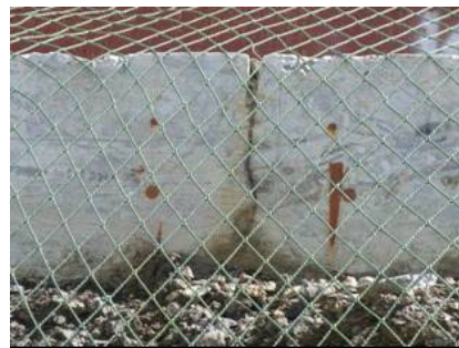
写真-11 目地部の側面 (一般国道 231 号石狩市浜)
