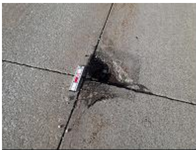
写真-2 目地部の破損 (隅角部)
