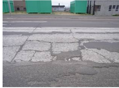
写真-9 疲労破壊による亀甲状ひび割れ
