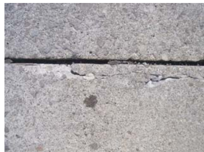
写真-12 目地部の側面 (一般国道 231 号石狩市浜)
