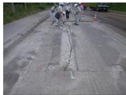
写真-6 疲労破壊によるひび割れ
