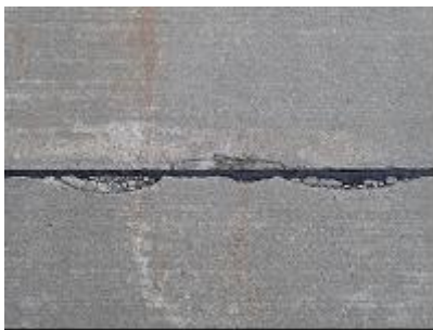
写真-1 目地部の破損 (角欠け)
