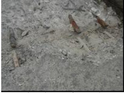
写真-8 破断したダウエルバー
