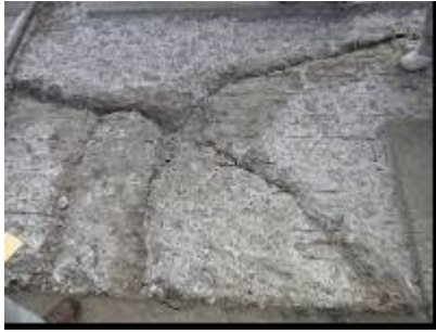
写真-7 疲労破壊による亀甲状ひび割れ
