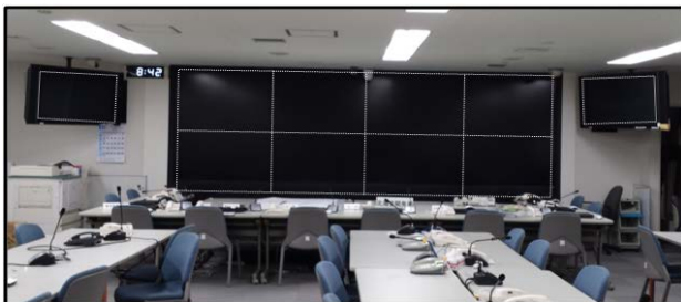
写真-4 災害対策室大型モニタ整備状況
