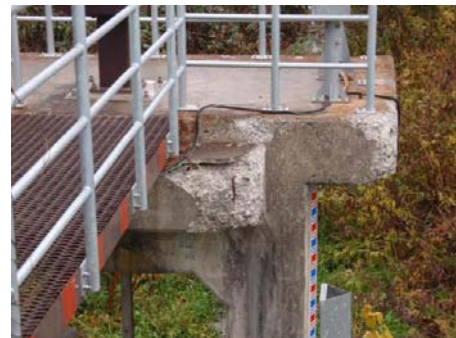
写真-1 損傷事例（操作台角部の欠損）
