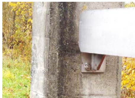
写真-2 損傷事例（門柱のひび割れ）
