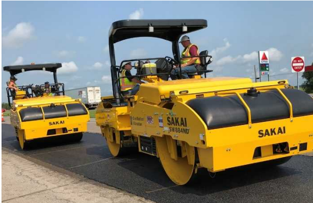
写真-2 米国で使用されている水平振動ローラの一例 (機械重量：約13t, 転圧幅：約2.0m)
