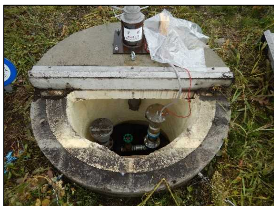
図-6 空気弁への水中型センサー設置状況
