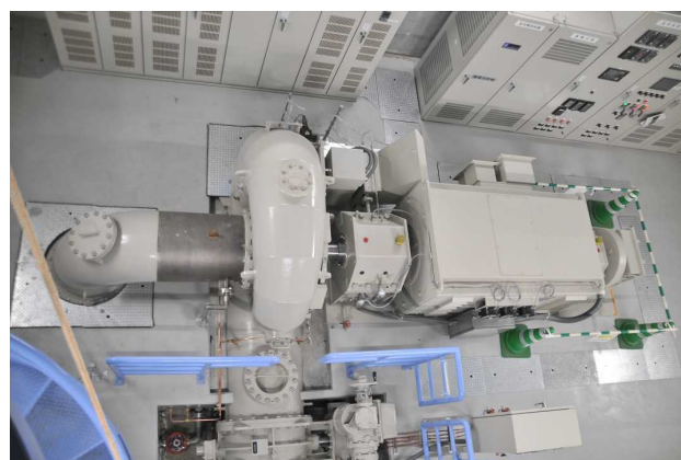
写真1 管理用水力発電設備
