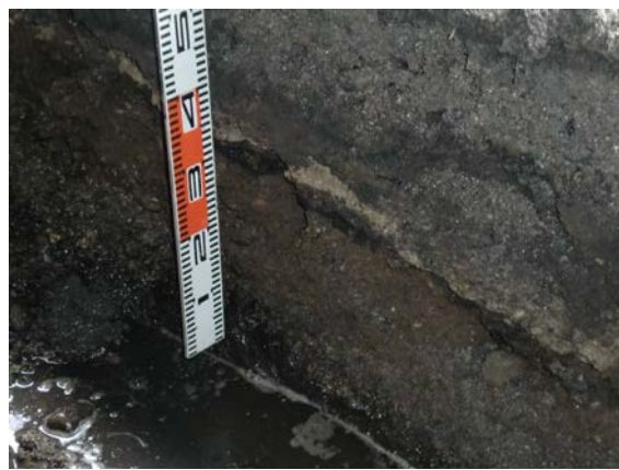
写真-7 路床部の地下水
