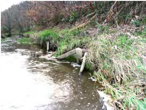
写真-3 コンクリート柵渠破損状況
