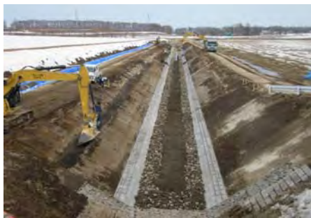
写真-15 河床の土底化
