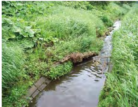
写真-2 連節ブロック破損状況
