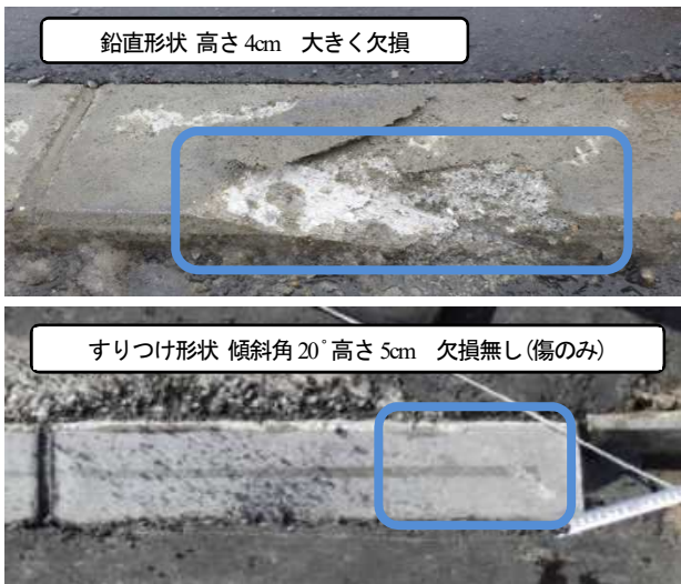
図4 除雪車によるエプロン端部損傷実験 23)
