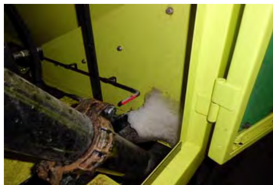
写真-11 ポンプ室内の雪の吹き込み状況
