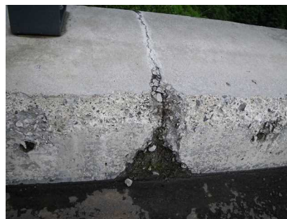
写真-1 初期ひび割れから凍害が進行した事例
