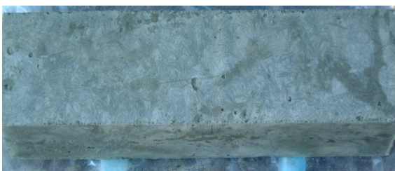
写真-2 初期凍害を受けたコンクリート
