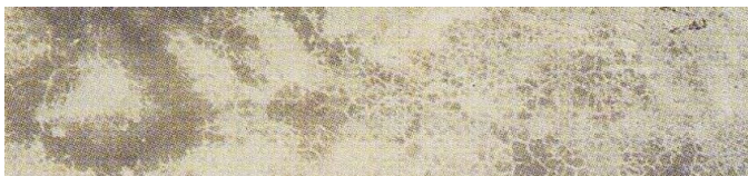
写真-1 養生中に急激に乾燥したコンクリート 1)
