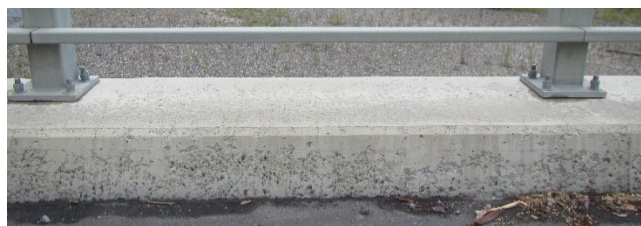
写真-4 スケーリングをおこしたコンクリート
