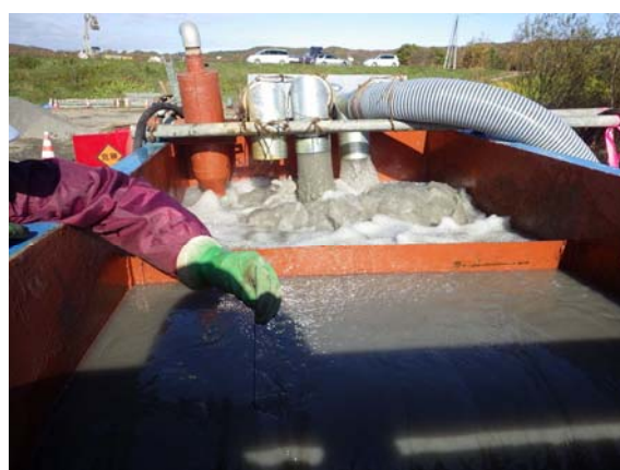
写真－7 揚水状況（ノッチタンク）
