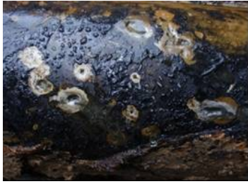
写真-2 腐食状況 (鋼管のすり鉢状の減肉)
