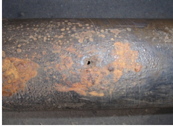
写真-1 漏水箇所 (空気弁立上鋼管)
