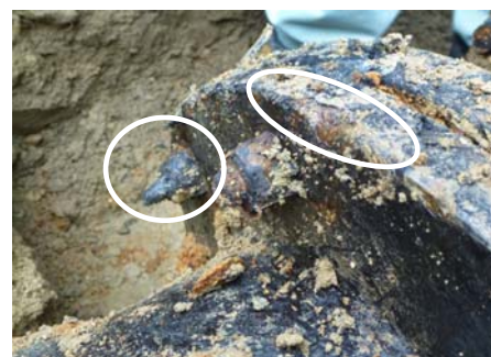
写真-4 DCIP接合材腐食状況 (ボルト先端部・フランジの減肉)
