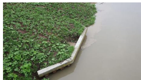
写真-10 管が脱落した流末工
