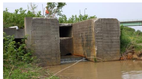
写真-11 躯体の劣化・損傷が進行した流末工
