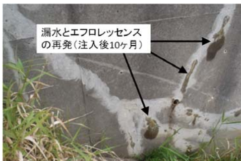
写真-1 注入後に再劣化したひび割れの事例
