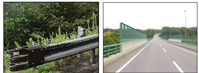
写真-2 道路施設の色彩の現状 (左: 塗膜の剥がれ、右: 鮮やかな緑系塗装)
