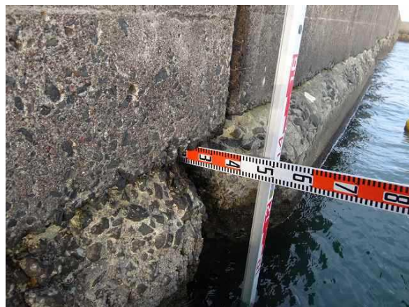
(b) 防波堤の損耗劣化状況 (目地部)
