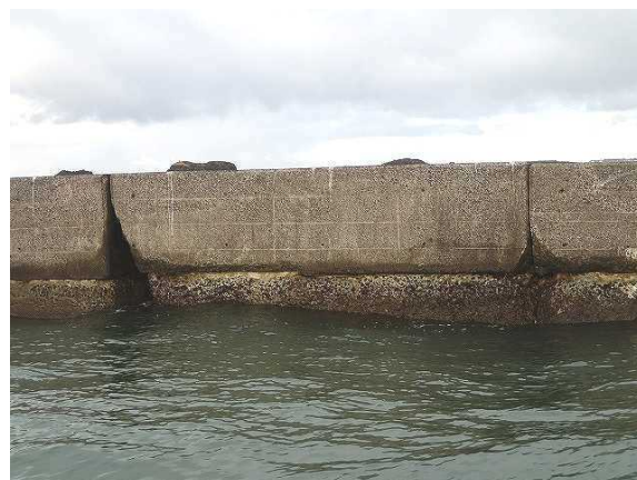
(a) 防波堤の損耗劣化状況 (全景)
