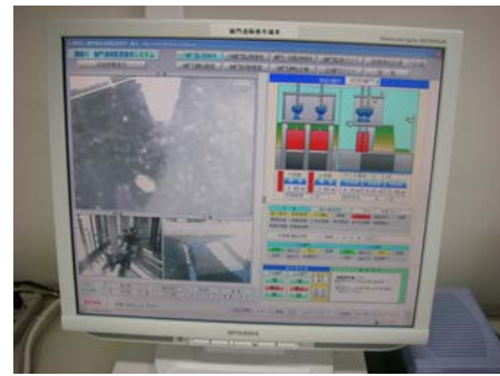
写真-6 監視・操作端末 (河川事務所)
