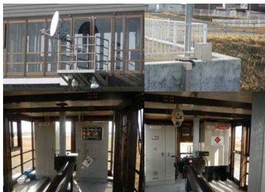
写真-8 樋門追加機材 (左上より受信機、地震計、PLC、発電機)
