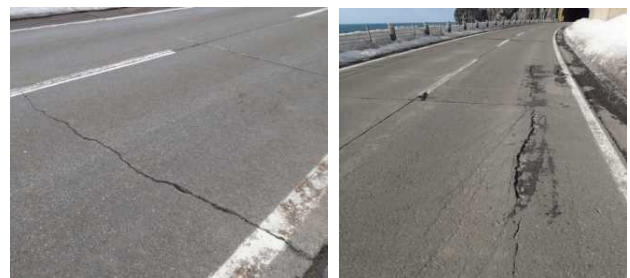
写真-1 Co版の構造的な破損 (左:横断ひび割れ、右:縦断ひび割れ)
