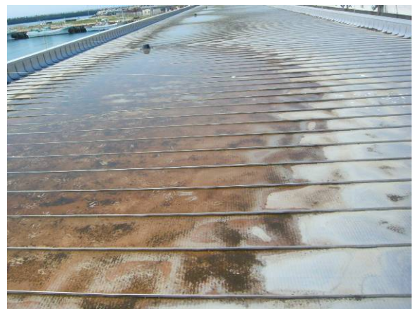
写真-4 ステンレス防水の水溜まり
