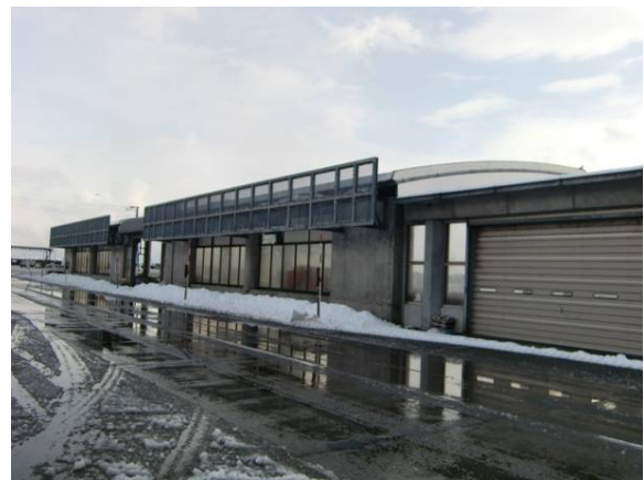
写真-7 雪止めフェンス
