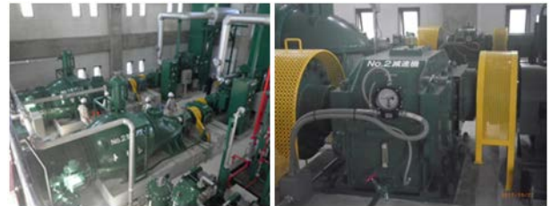
図-1 排水機場ポンプ設備(左)と減速機(右)
