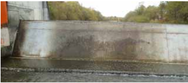
写真-7 洪水吐ゲート の摩耗状況（拡大）
