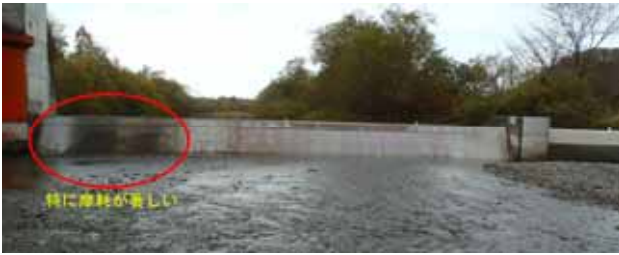
写真-6 洪水吐ゲート の摩耗状況（全体）
