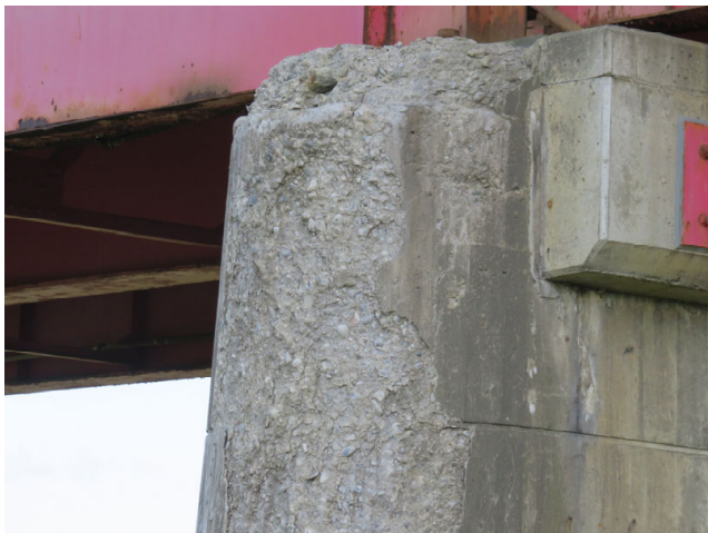
写真-1 スケーリング (道路橋橋脚)
