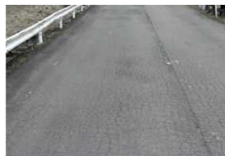
図-3 判定用写真の例(ひび割れ率診断区分III)
