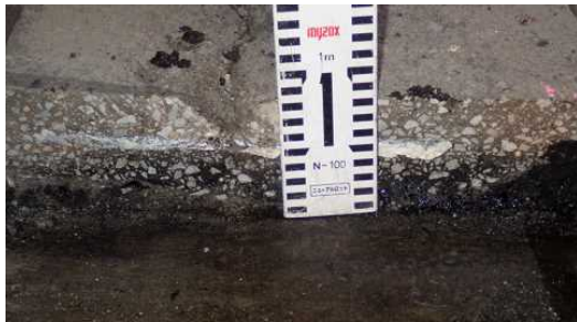
写真-3 調査箇所 A 損傷状況
