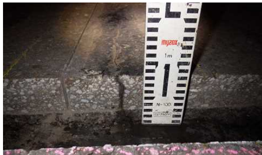
写真-5 調査箇所 C 損傷状況
