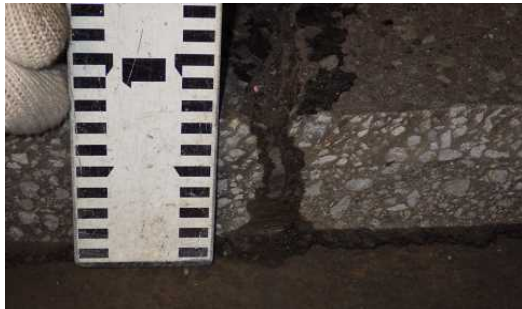
写真-4 調査箇所 B 損傷状況
