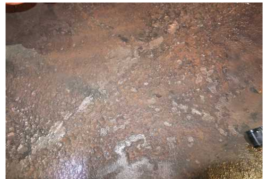
写真-9 調査箇所B 腐食箇所接写
