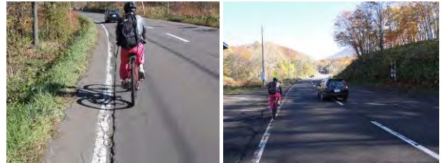
写真-5 自転車走行空間における路面クラック
