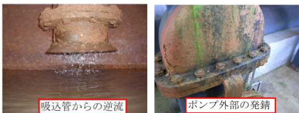
図-3 ポンプ設備の劣化状況
