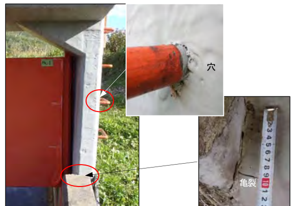
写真-8 C工法の門柱の状態
