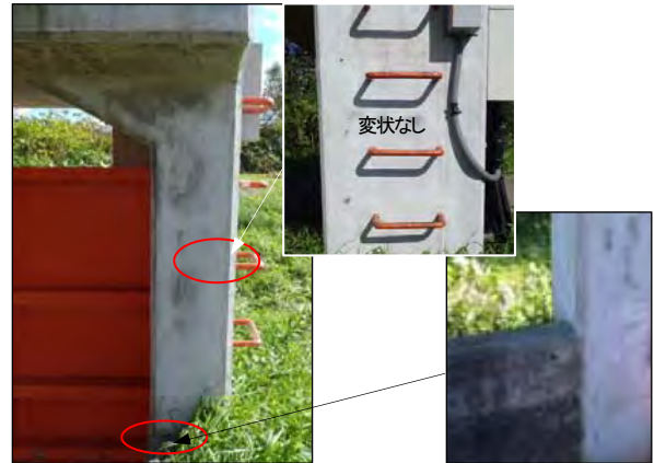
写真-6 A工法の門柱の状態
