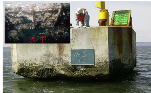
写真-1 氷海域におけるコンクリート構造物の劣化状況
