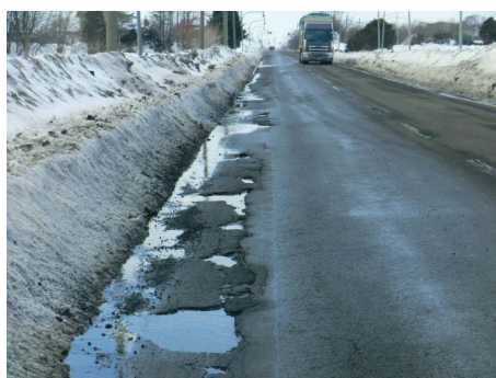
写真-1 融雪期のポットホール発生状況
