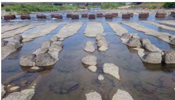
図8 床止工天端の摩耗状況
