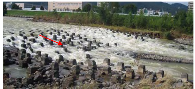
図5 床止工下流側護床工直下流の洗掘（右岸側）
