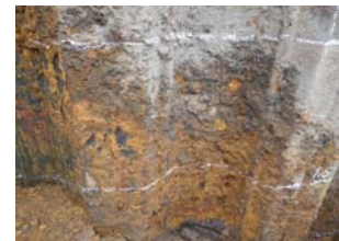
写真-3 凸凹の激しい腐食 （第1号落差工土中部）
