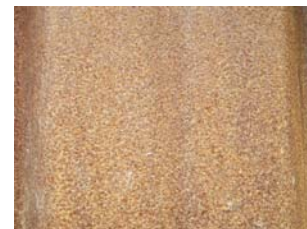
写真-4 比較的平坦な全面腐食 （第1号落差工気中部）
