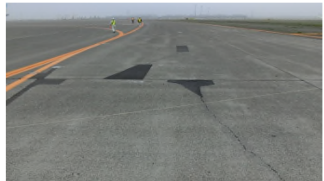
写真-6 J3～J4誘導路のひび割れ
