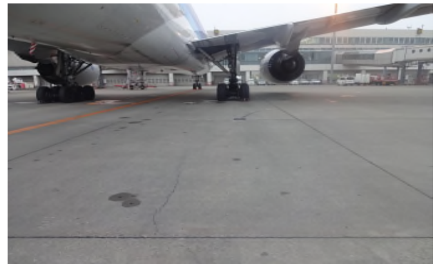
写真-5 駐機9番スポットにおける主脚位置のひび割れ
